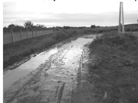
Дорога д. Аргуново до ремонта
